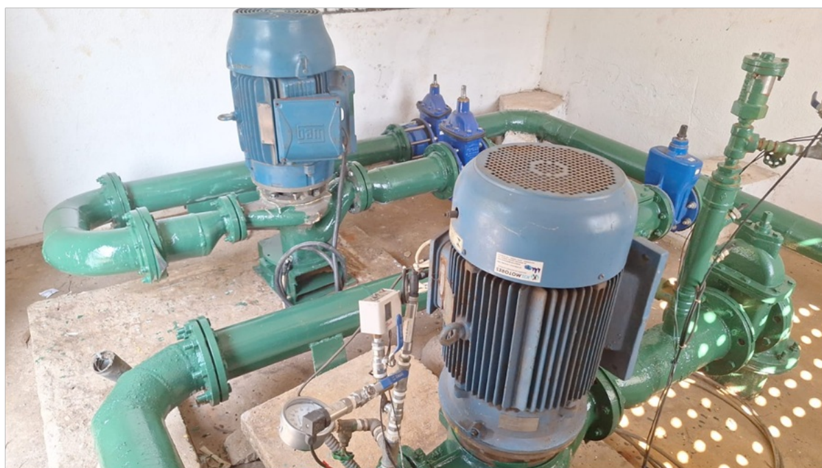
Foto 5 - Vista interna da montagem, com a sucção a direita e o recalque a esquerda.
