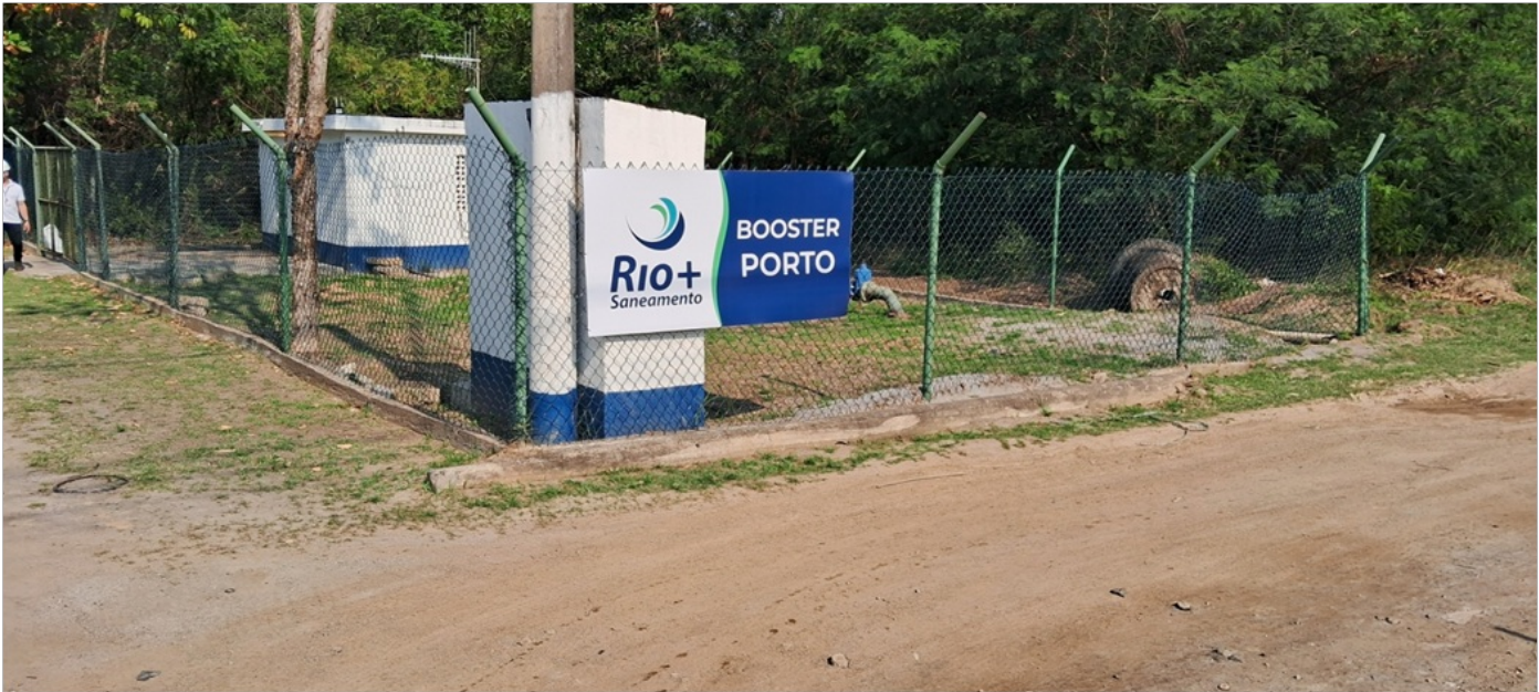
Foto 2 – Booster do Porto, com cerca, identificação, PC .
