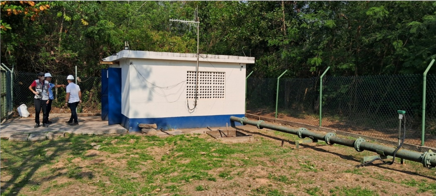
Foto 3 – Vista do prédio com antena para telemetria, monovia, portão de acesso, recalque com macromedidor,ventilação do prédio.
